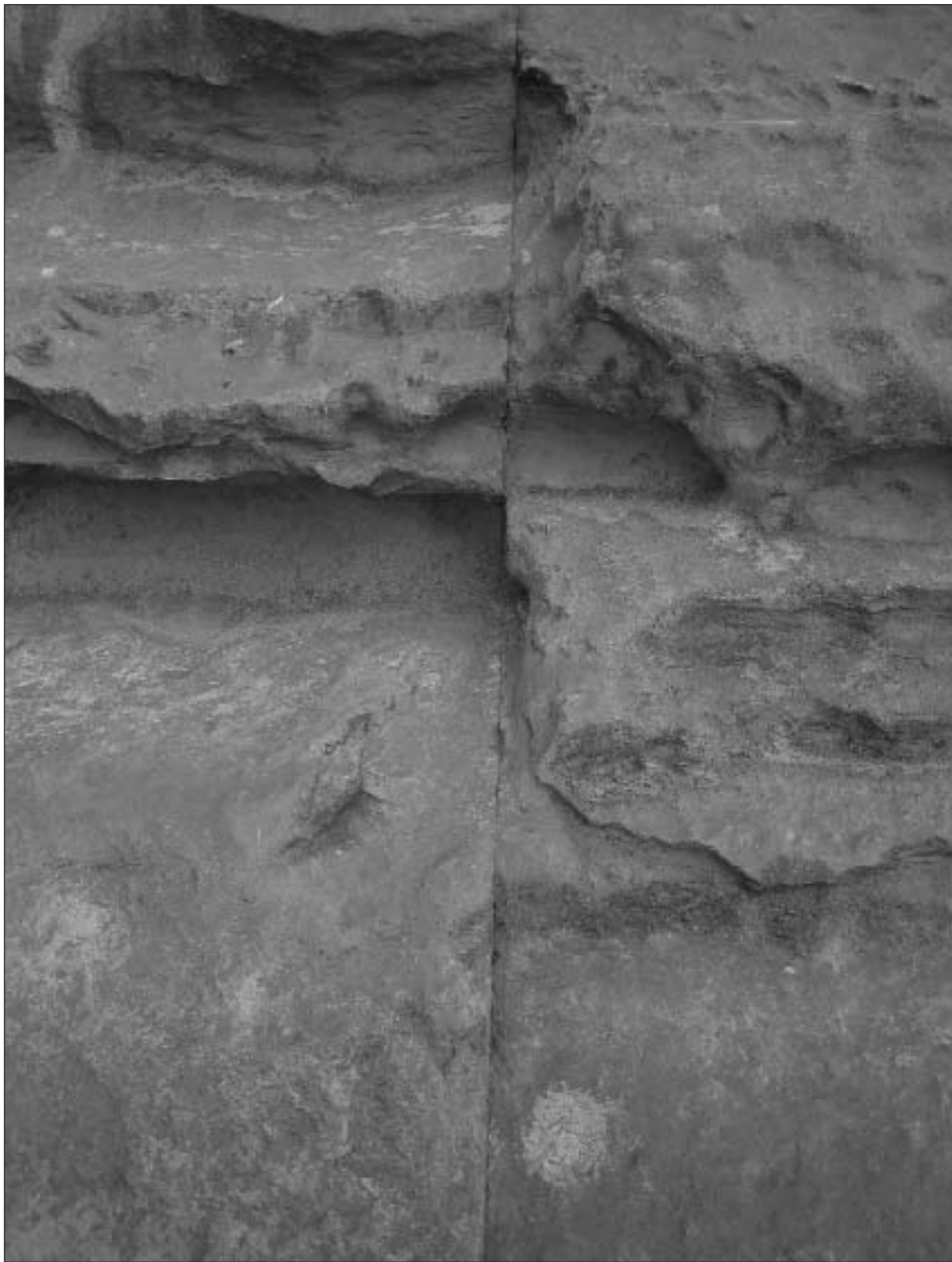
Auch hier wieder gut sichtbar: Die Steinblöcke passen mit einer außergewöhnlichen Genauigkeit zusammen, andererseits erkennt man den hohen Verwitterungsgrad.
