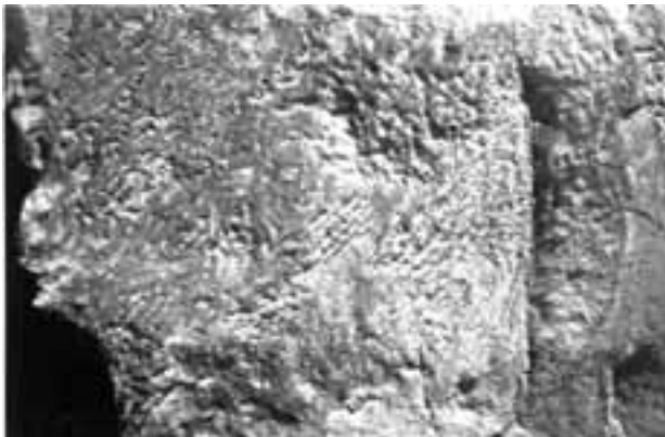
Ein Ausbruch eines Segments, wo der Trennschneider nicht in der Ebene blieb.
