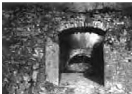
Blick in das tiefer gelegene alte Klostergebäude. Das Dach ist noch teilweise erhalten, ansonsten jedoch eingebrochen. In der Bildmitte der zusammengeschobene Schutt.
