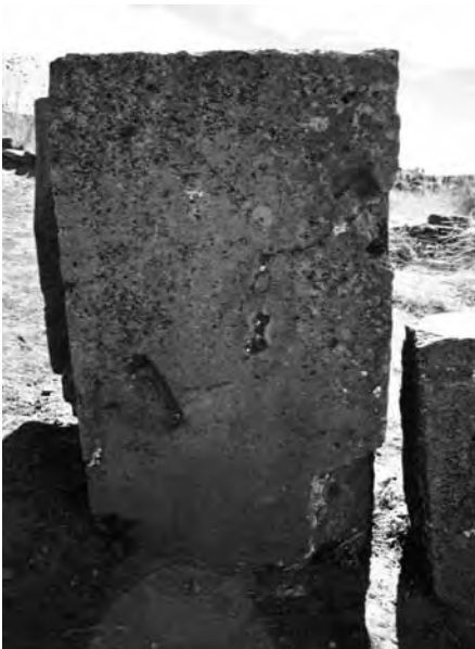
Abb. 9 – Puma Punku. Ansicht eines gerissenen Steines, der mit der Hilfe von Klammern repariert wurde.
