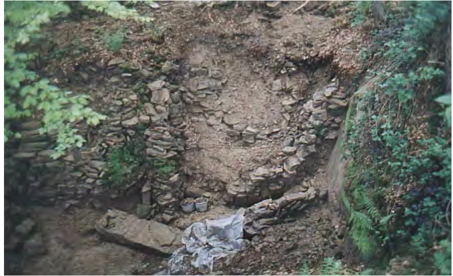
Abb. 9 - Das zugebaute Portal mit drei freigelegten, z. T. eingestürzten Schutzmauern.
