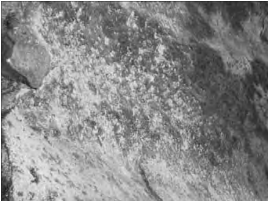
Abbildung 16: Scharrierungen oberhalb der glatten Bank
