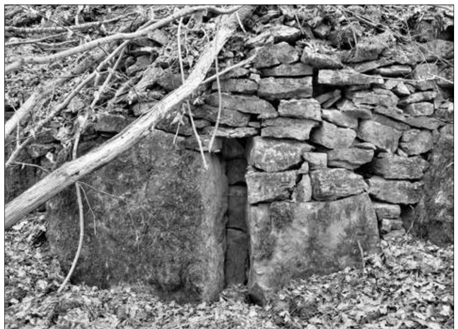
Bild 18: Weitere verschlossene Hohlräume.
