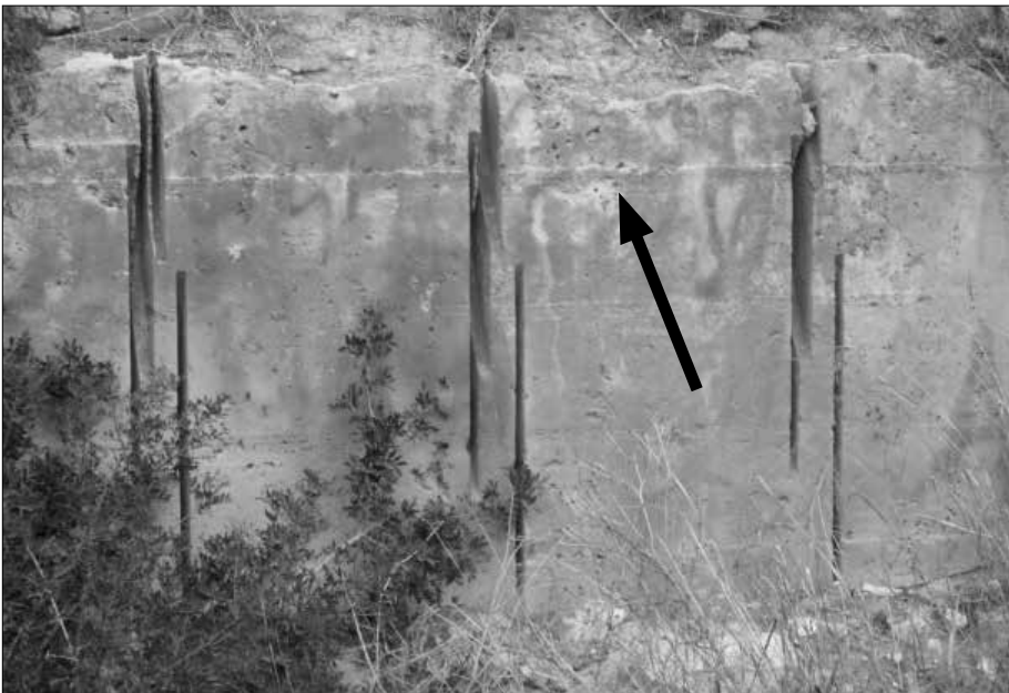
Abb. 14: Ist das (Pfeil) vielleicht ein Gieß- oder Quetschwulst von Beton?
