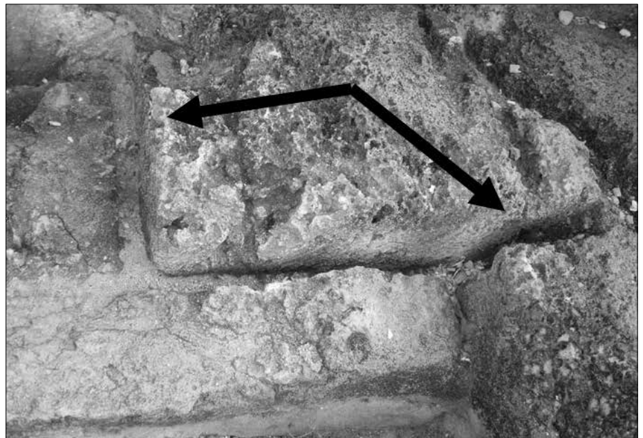
Abb. 11: Das sieht nach dem Einsatz einer großen Trennscheibe aus.
