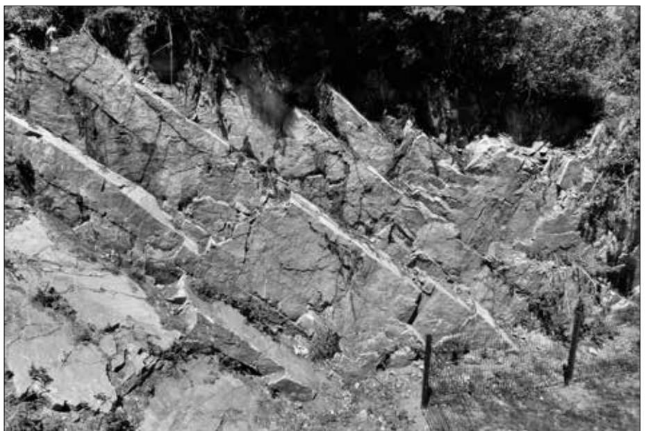
Bild 9: Rissige, gespaltene Steine.
