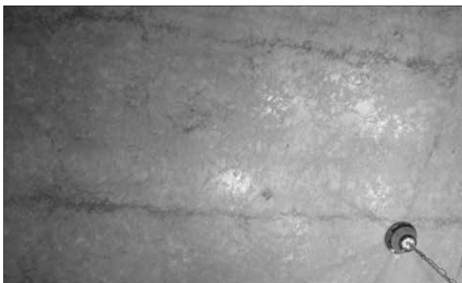
Zum Vergleich hier eine heutige Betondecke, die unbehandelt blieb. Man erkennt, dass auch beim Betonieren spiegelglatte Flächen entstehen können. Es kommt auf die verwendete Verschalung an!
